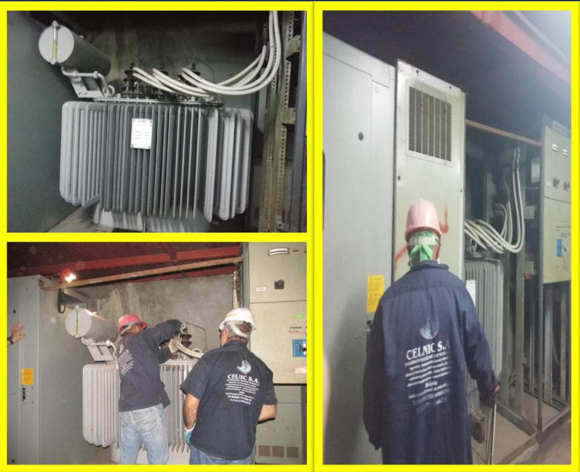
TRANSFORMADOR SUSTITUIDO DE 400 KVA EN EL TNRD
