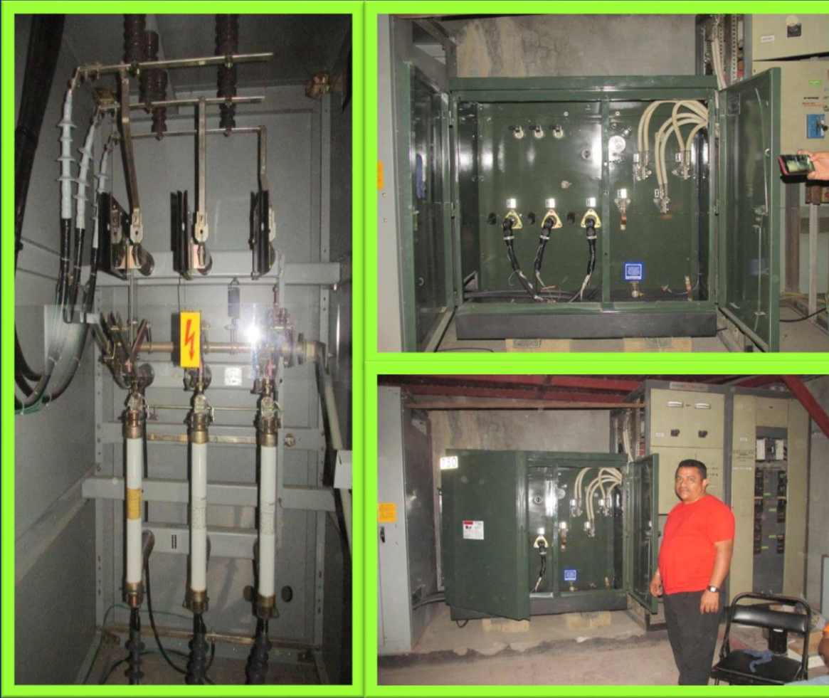
TRANSFORMADOR INSTALADO DE 750 KVA EN EL TNRD
