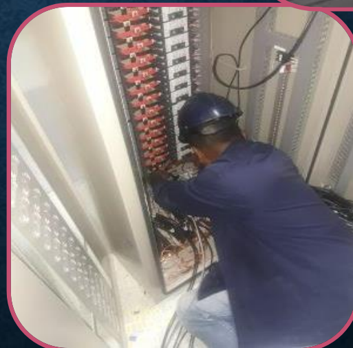
Conexión de paneles de protecciones y de control en nuevas bahías 230 kV.
