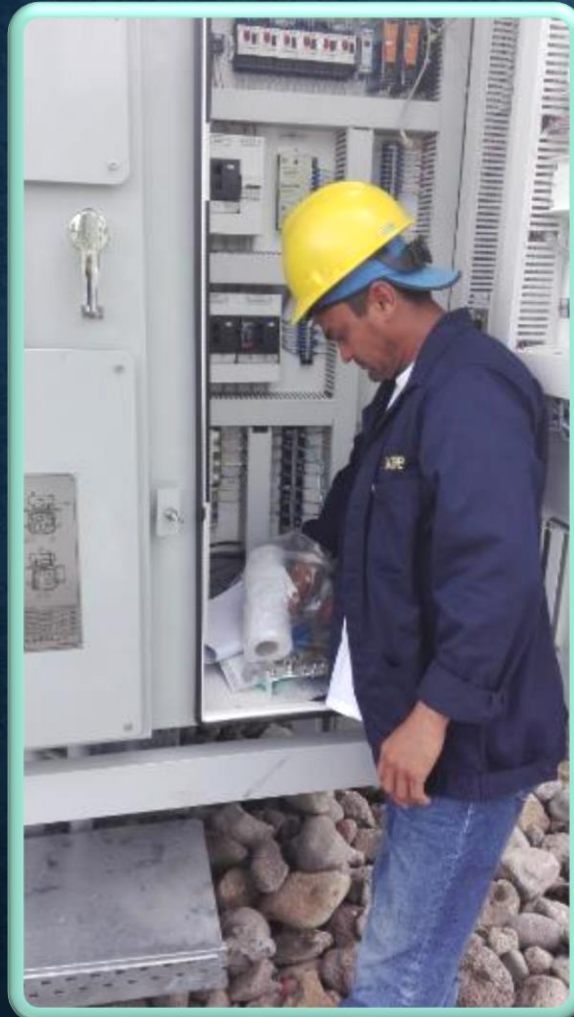
Pruebas a ventiladores del autotransformador de Potencia 230/138 kV.
